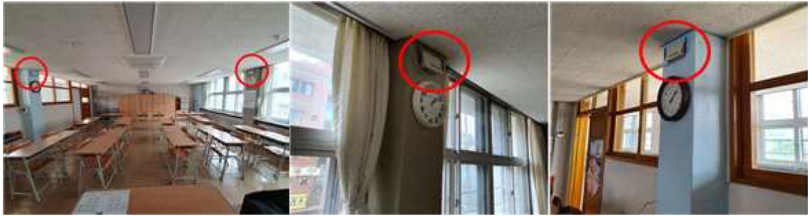
그림 1. 교실 내 IoT 기반 실내공기질 측정 장비 설치 모습 (원: 전경, 중앙: 창가쪽 센서, 우:복도쪽 센서)
