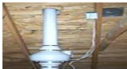
④ 저감팬 설치
